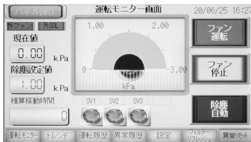
タッチパネル式運転モニター
